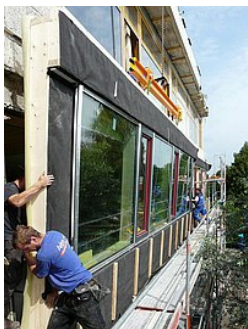
Montage vorgefertigter Fassadenelemente bei der Sanierung eines Schulgebäudes. (Foto: Anton Ambros GmbH)
