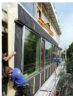
Montage vorgefertigter Fassadenelemente bei der Sanierung eines Schulgebäudes. (Foto: Anton Ambros GmbH)
